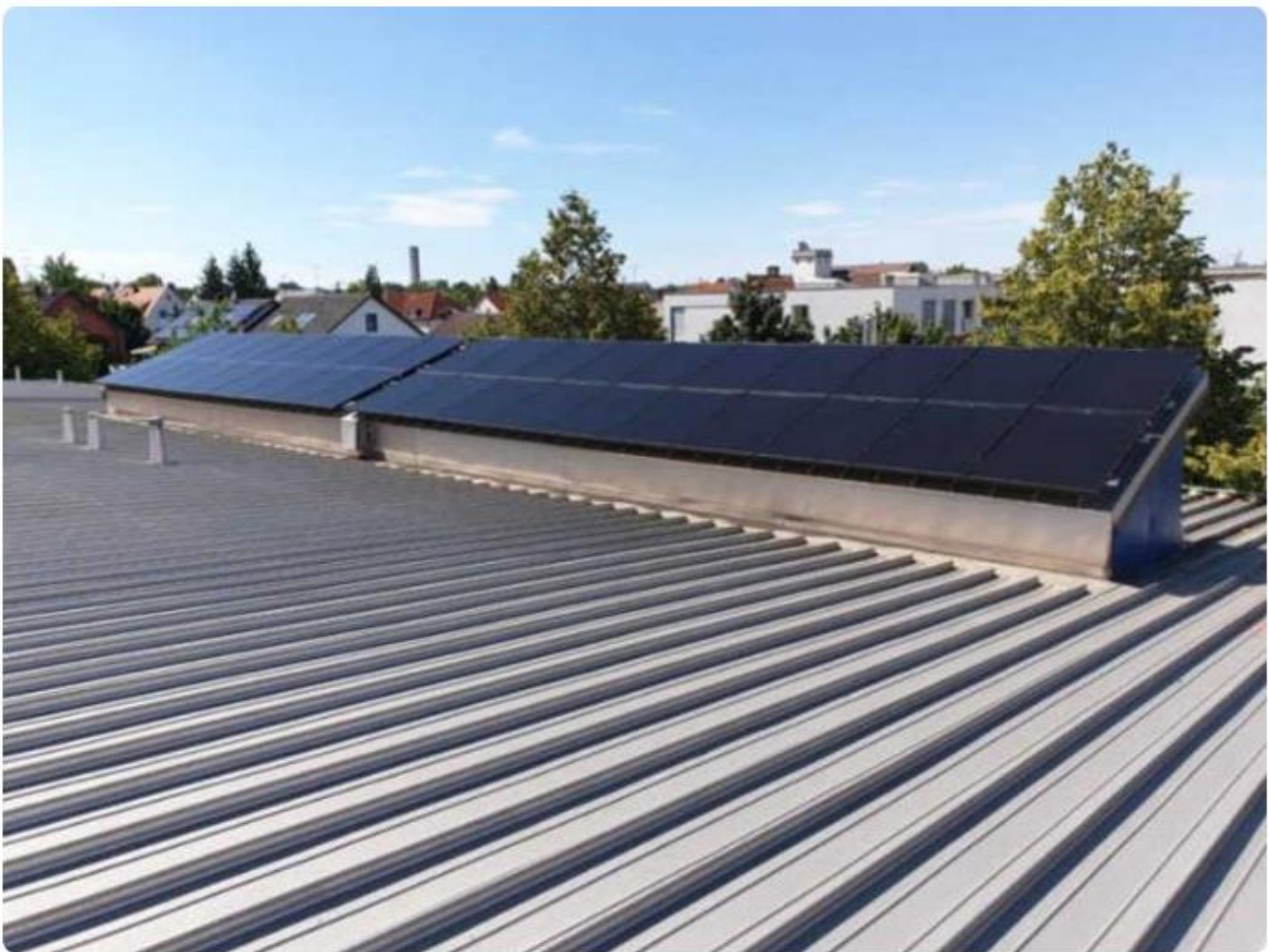
Solarmodule auf dem Dach des städtischen Kindergartens Gersthofen.
